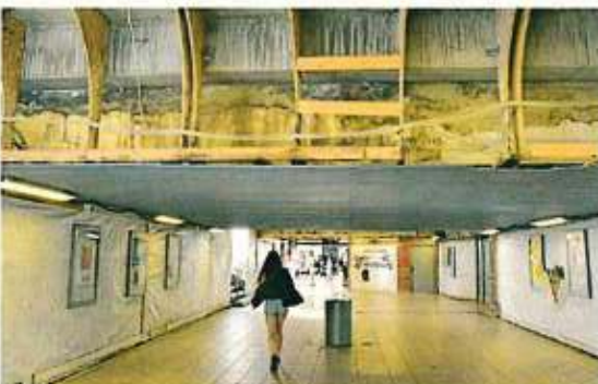
Die Decke ist freigelegt, die Wände sind mit Folie abgedeckt: Den Wasserschaden im Rendsburger Bahnhof bekommt die Bahn nicht in Griff.
